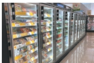
自然冷媒の 冷凍ケース
